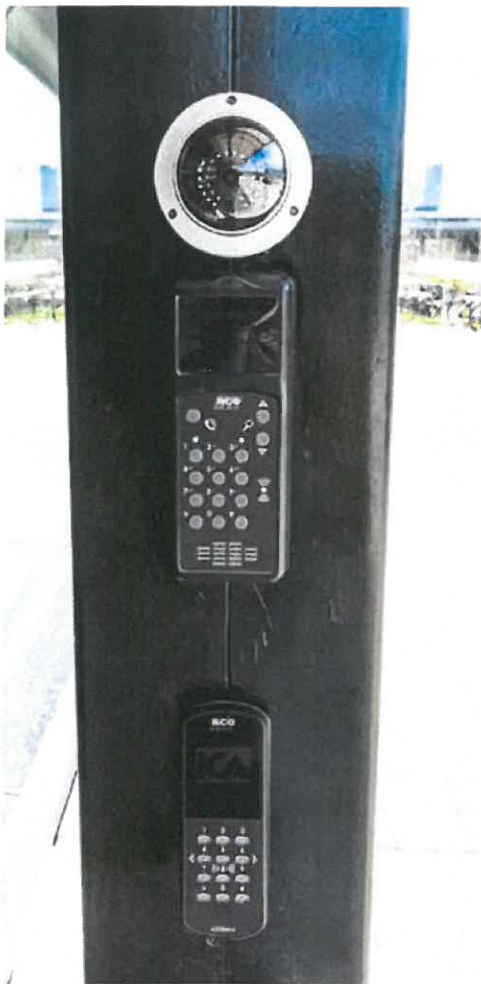
Vid entréer för besökare har man kompletterat passersystemet med porttelefon.
